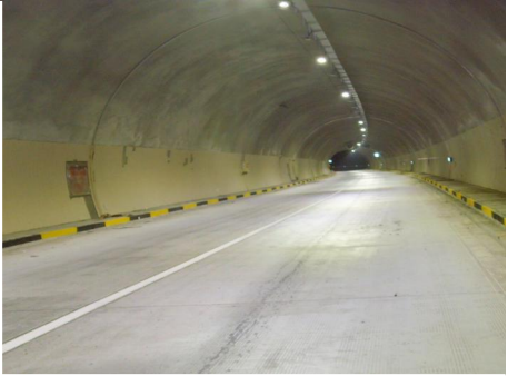
▲ 安徽六潜隧道LED照明工程
